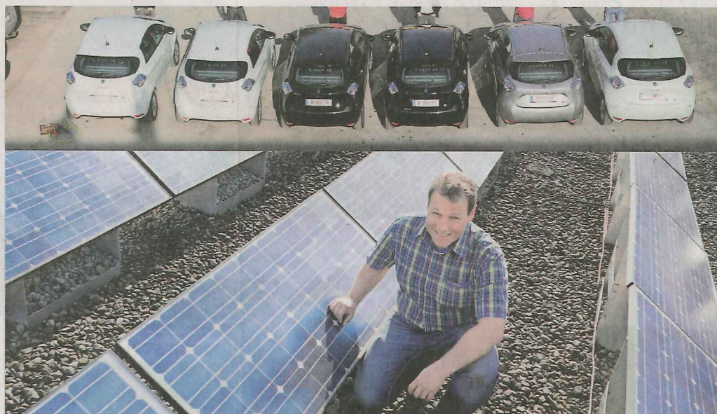
Eine PV-Anlage am Dach des Haustechnik-Planungs-Unternehmens E-Plus produziert so viel Strom, wie die sechs Autos im Jahr brauchen werden.
